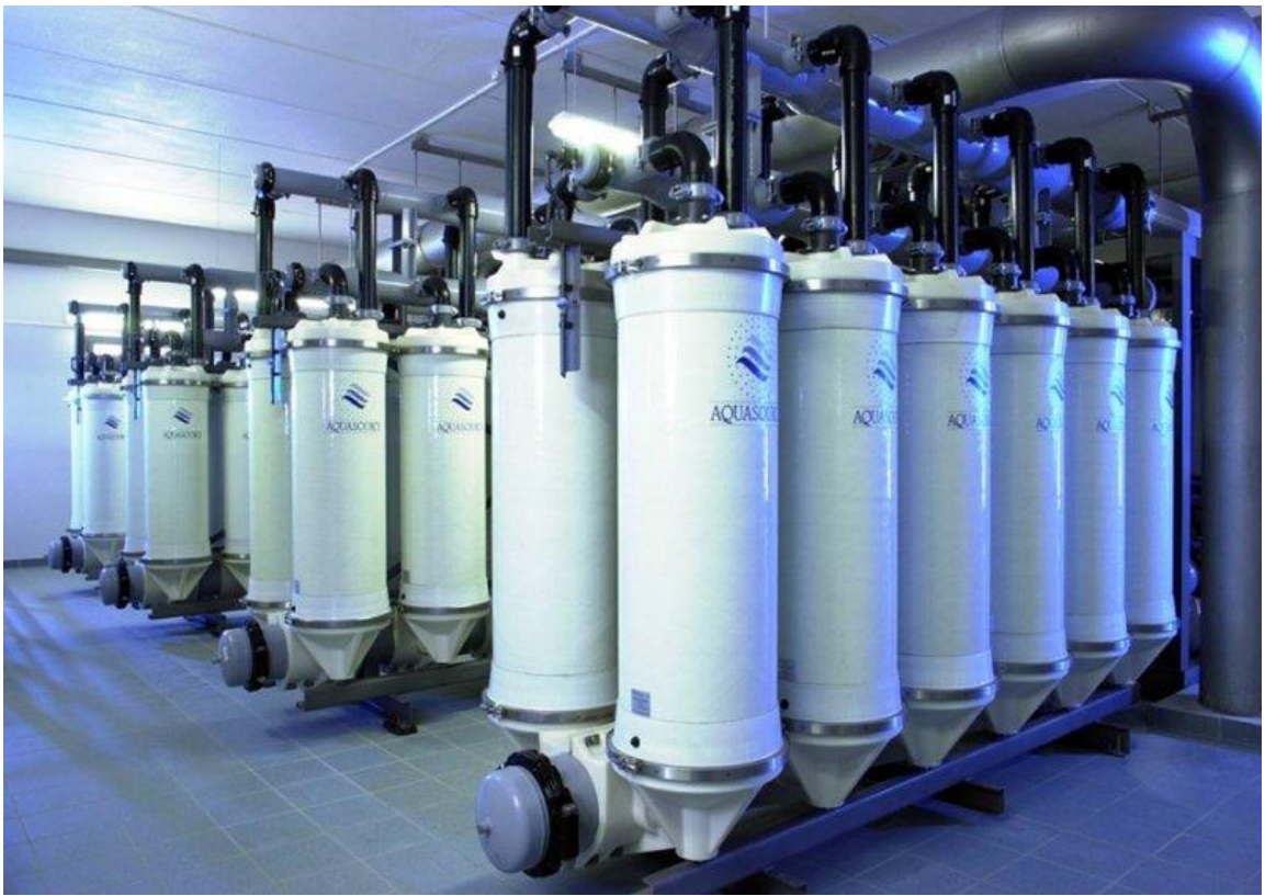
Рис. 5.6. Юго-западная водопроводная станция г. Москвы. Ультрафильтрационная установка
